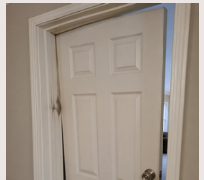
JAMMED DOOR OR STUCK DOOR
